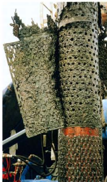
Bild 5: Filterausbau; das Schlitzblech ist durch Tonmaterial gänzlich verschlossen
