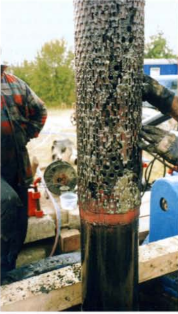
Bild 4: Gelochtes Filterrohr mit stark korrodiertem Schlitzblech
